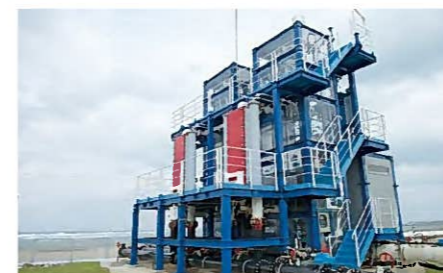
海洋深層水を くみ取る ポンプ施設
